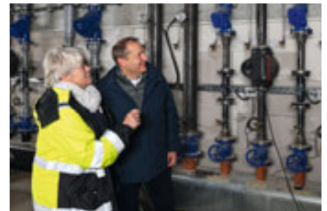
Begutachten die Energiezentrale: Jutta Herfurth und Thomas Klemke
